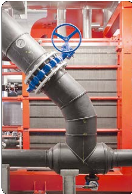
Den første fjernkølecentral i København åbnede i 2010 og den anden åbnede i 2013. I dag er der fjernkøling i hele indre by, samt København Nordvest. Foto: Hofor.
