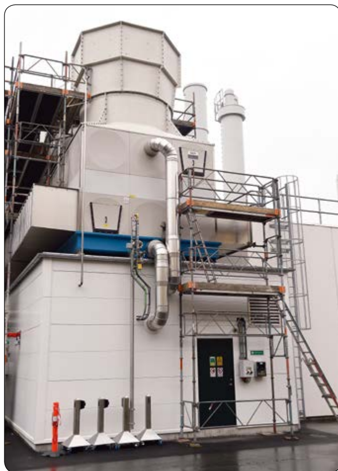
1001 Fritstående isoleret teknikbygning, som indeholder kølekompressor, varmevekslere, pumper, shuntventiler, vandbehandlingsanlæg m.m. Oven på bygningen er monteret de to køletårne.
