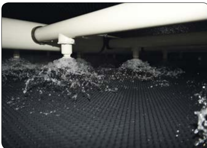
1006 Varmt kølevand kommer retur og sprøjtes ud over køletårnets "kassetter" for at skabe stort kontaktareal mellem varmt vand og kold køleluft i modstrøm.
