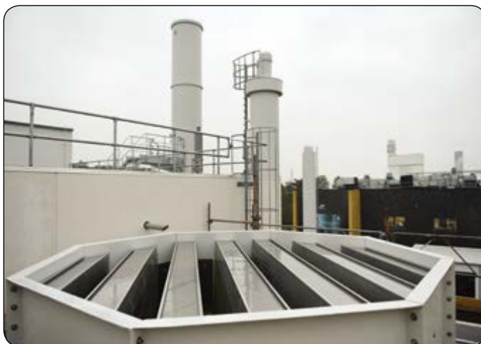
1008 Lyddæmpende luftafkast fra køletårn. Der er skærpede krav til lydniveau, da fabrikken ligger nær boligområde.
