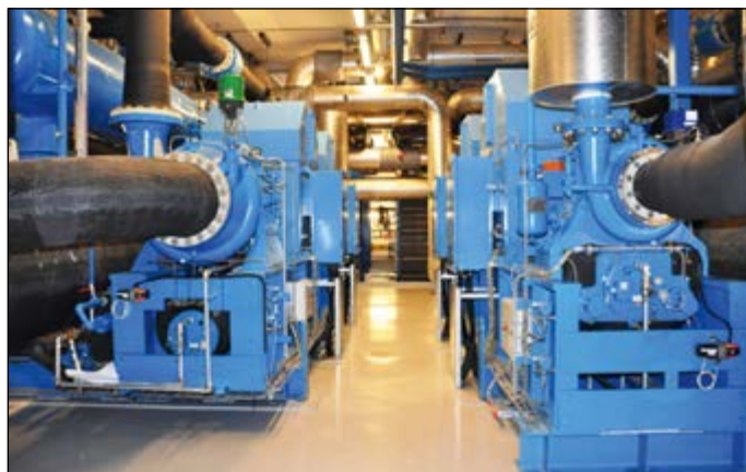
Varmepumpene på plass under hotellet.
