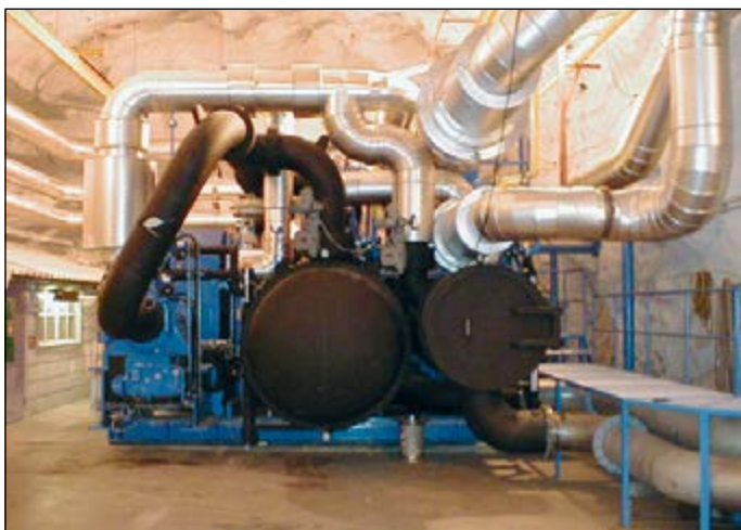
Varmepumpe nr. 3 på plass og i drift i 2008. Rør for avløpsvann nede til høyre.
