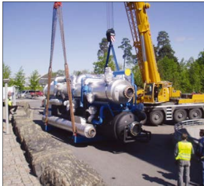
Varmepumpe nr. 2 ble losset i mai 2006. I bakgrunnen skimtes en flyhangar der Telenor Arena senere ble bygget.
