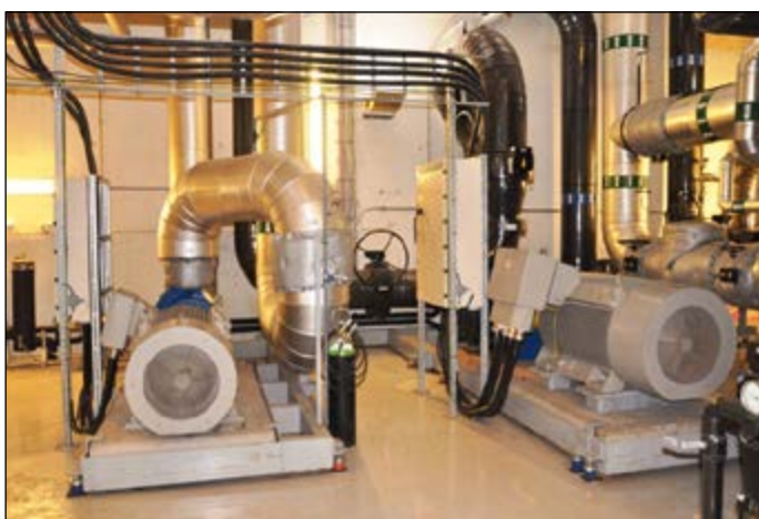
Sirkulasjonspumper for fjernvarme og fjernkjøling.
